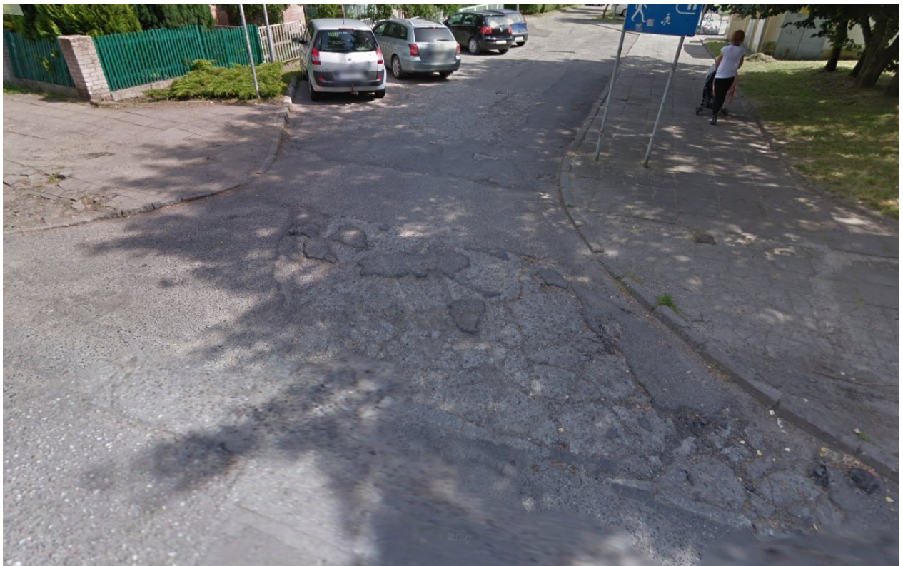
Fot. 4 Stan nawierzchni skrzyżowania z ul. Bogusława X – źródło https://www.google.pl/maps
