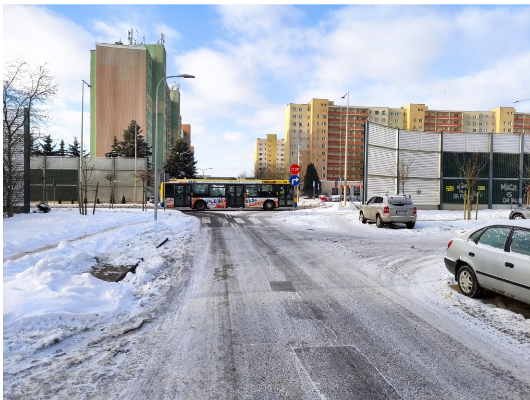
fot. 2 Wizja lokalna w terenie – zniszczenia nawierzchni - spękania podłużne, siatkowe, łaty. Widok w stronę ul. 11 listopada
