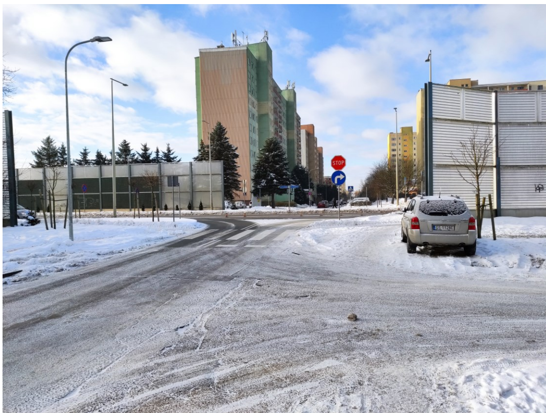
fot. 1 Wizja lokalna w terenie – zniszczenia nawierzchni – spękania siatkowe, podłużne i poprzeczne. Widok w stronę ul. 11 listopada
