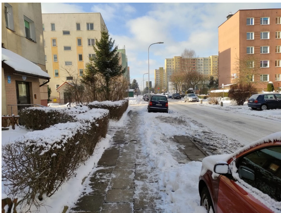
fot. 4 Wizja lokalna w terenie – nierówności i wykruszenia na chodniku
