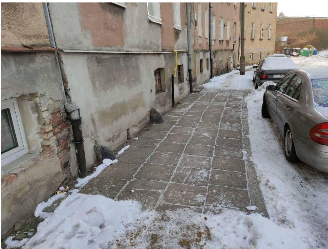
fol. 5 Wizja lokalna w terenie – nierówności istniejącego chodnika wzdłuż budynków po stronie wschodniej
